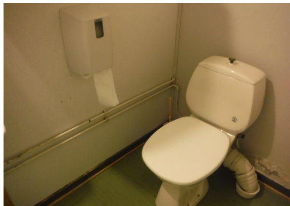
Figur 7: Sanitærutstyr fra byggeår
