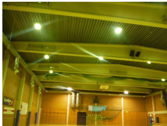
Figur 2: Mulig svakt dimensjonert takkonstruksjon
