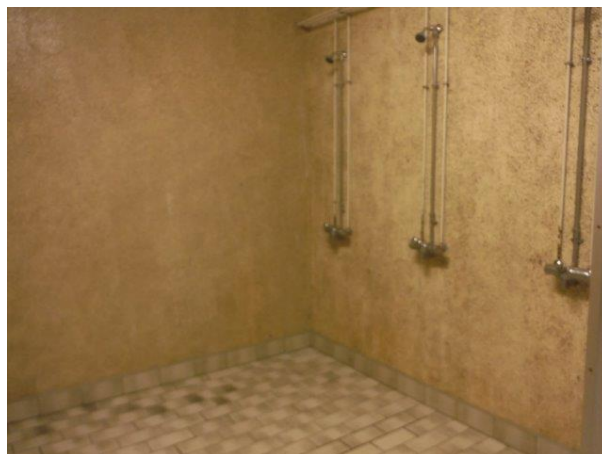
Figur 4: Dusjanlegg generelt moden for totalreovering
