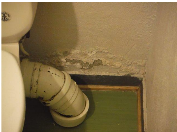
Figur 5: Fuktskader i vegger dusjrom
