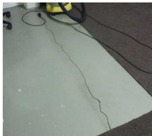
Figur 5: Systematisk sprekk dekke alle akser
