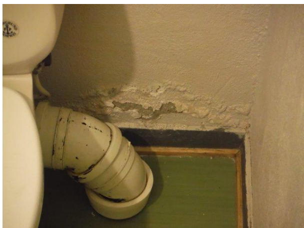
Figur 4: Fuktskader i vegger dusjrom
