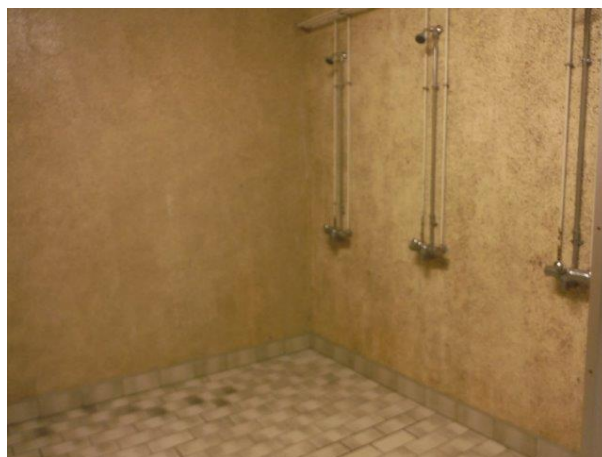
Figur 3: Dusjanlegg generelt moden for totalrenovering
