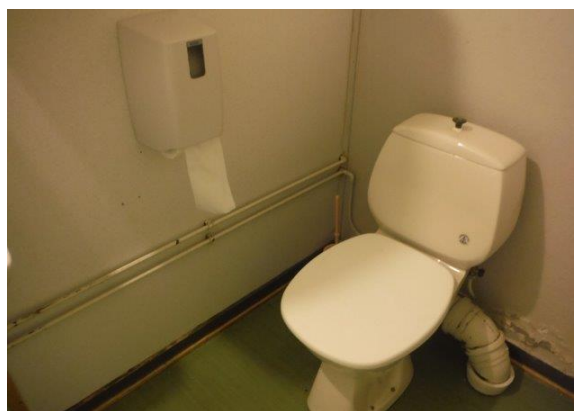
Figur 6: Sanitærutstyr fra byggeår
